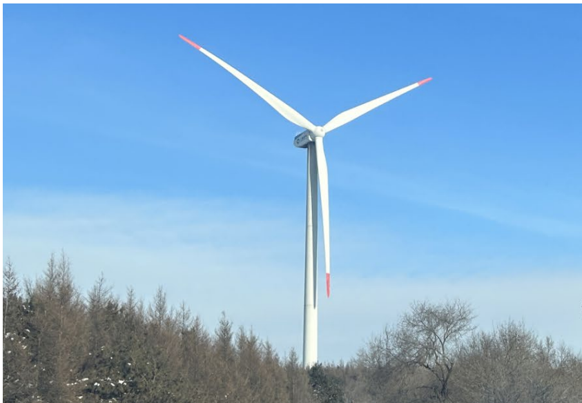
哈尔滨宾县锐驰风电场 变桨改造单机容量2MW SPS103变桨系统
