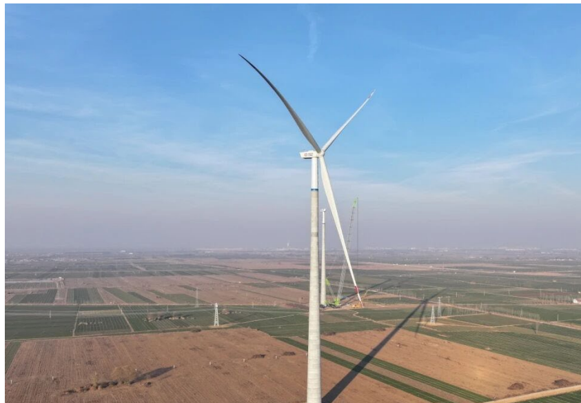
河北邯郸龙高风电场 变桨改造单机容量6.25MW SPS103变桨系统
