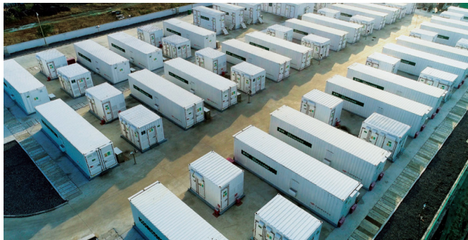
镇江东部 101MW / 202MWh 储能项目
