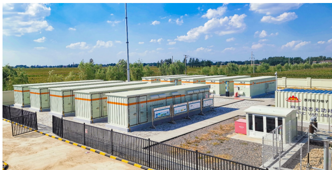
华润安徽滩溪风电场配套储能电站
