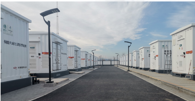
冬奥会智能变电示范站 - 国网冬奥 220kV 变
