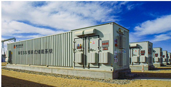
青海海西州 50MW/100MWh 储能电站
