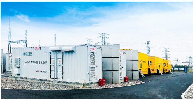
浙江金华 1# 应急电源基地 17MW / 34MWh 储能电站
