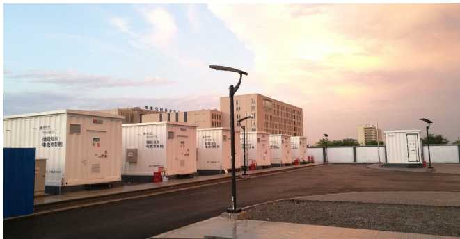
北京怀柔科学城 15MW/30MWh 储能电站
