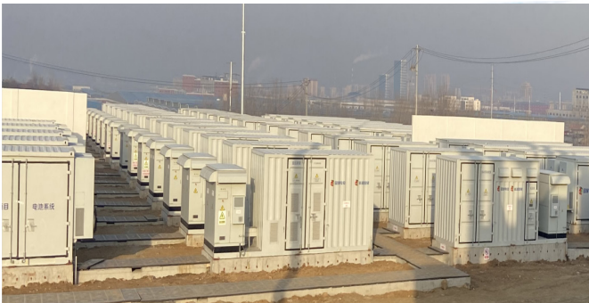
国电投山东沂水电化学储能系统
