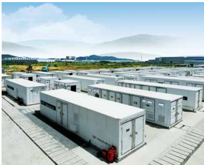
2018 年第一批电网侧单体最大储能电站镇江五峰站
