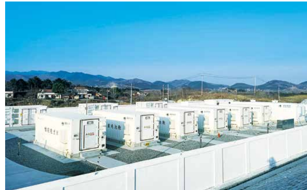
2023 年世界首个县域 100% 新能源新型电力系统科技示范工程湖北广水马寨村储能电站项目
