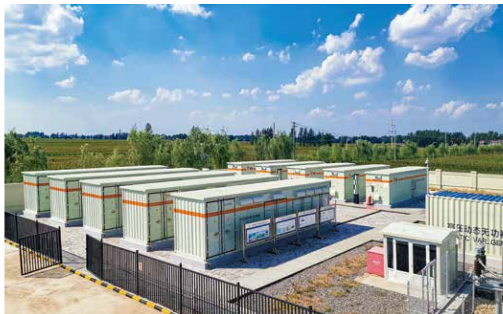
2020 年国内首个商业化风电配储能华润滩溪风电场 10MW / 10MWh 储能系统
