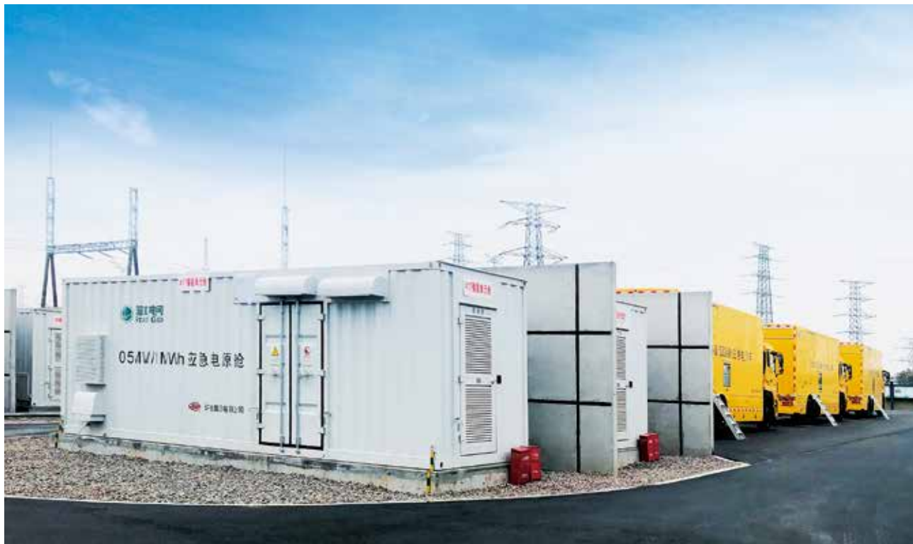
2022 年国内首个可移动共享储能应急电源基地金华基地浙江金华公司 电网 1# 应急电源基地工程储能项目
