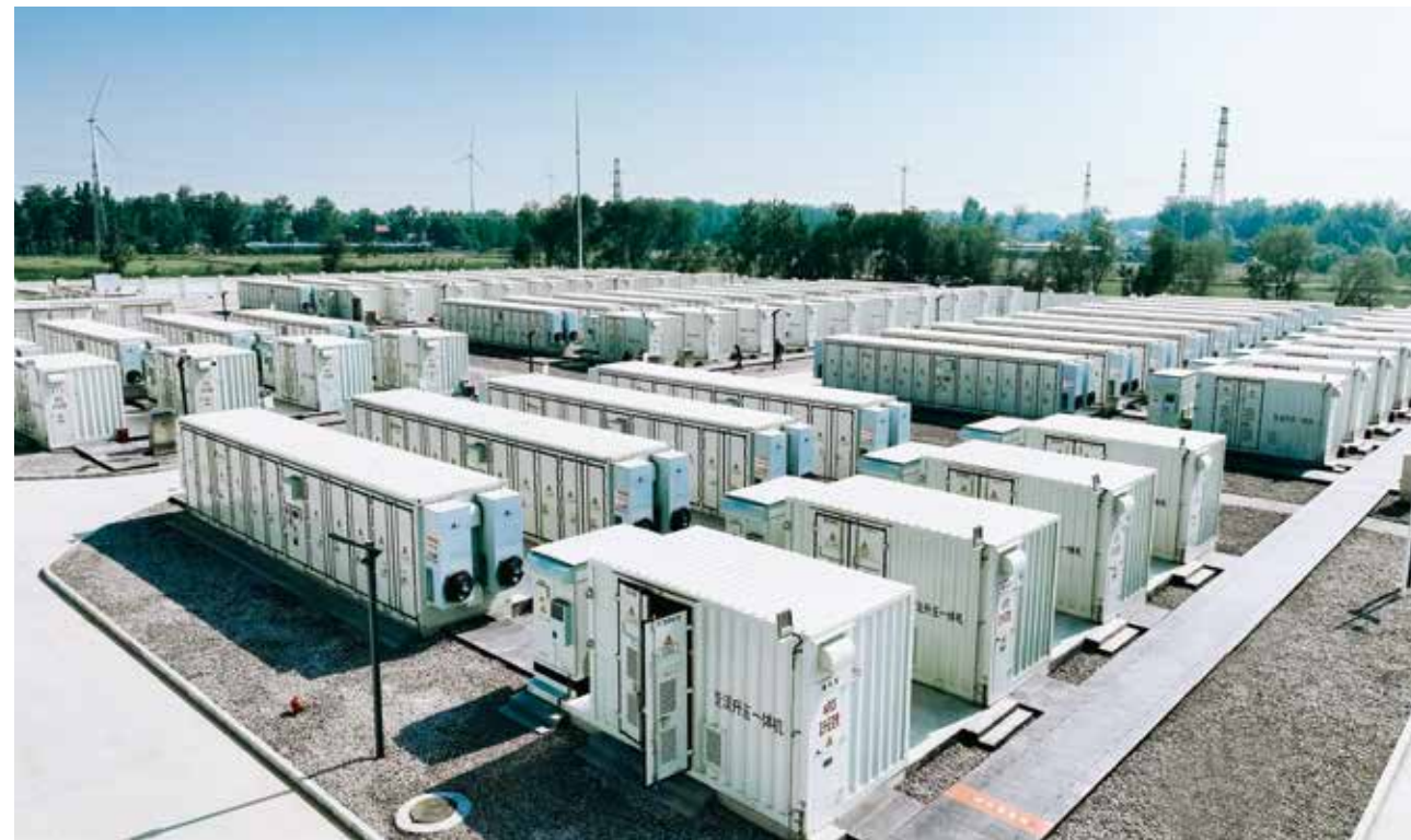
2022 年山东重点储能项目 - 华润电力鄞城源网储一体化示范项目
