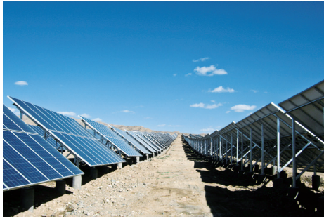
青海神光新能源格尔木 50MW 光伏电站
