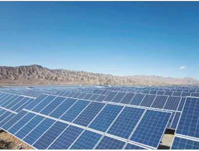
青海乌兰 50MW 并网光伏电站
