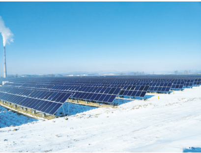
辽宁东方发电有限公司储灰场 20MWp 光伏农业发电项目
