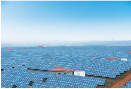
国家风光储输示范工程
