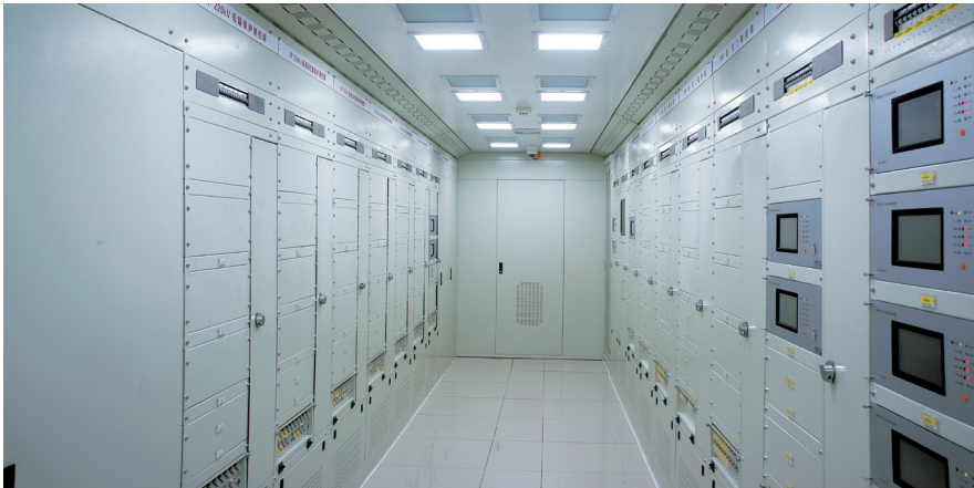
湖北郧县 220kV 变电站
