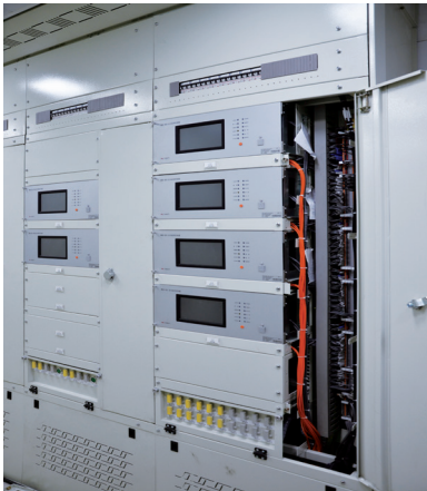
机架内开放式走线通道
